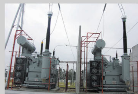
茂名变电站 ODFPS-250MVA/500kV Maoming substation ODFPS-250MVA/500kV
