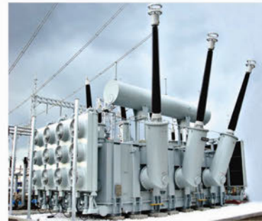
国内首台500kV 智能变压器 长春南 China's first 500 kV intelligent transformer Changchun South Substation
