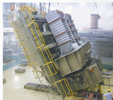
铁芯起立装置 Core erecting cradle
