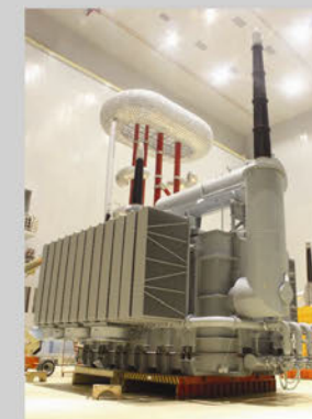
狮洋变电站 ODFPS-500MVA/500kV Shiyang substation ODFPS-500MVA/500kV
