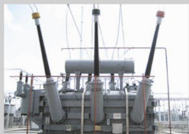
云南墨江变电站 OSFPS-750MVA/500kV ASA变压器 Mojiang Substation, Yunnan OSFPS-750MVA/500kV ASA
